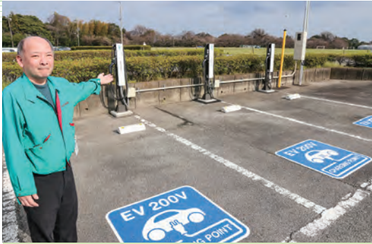
EV車の充電スタンドを設置した鈴鹿さつき温泉駐車場
